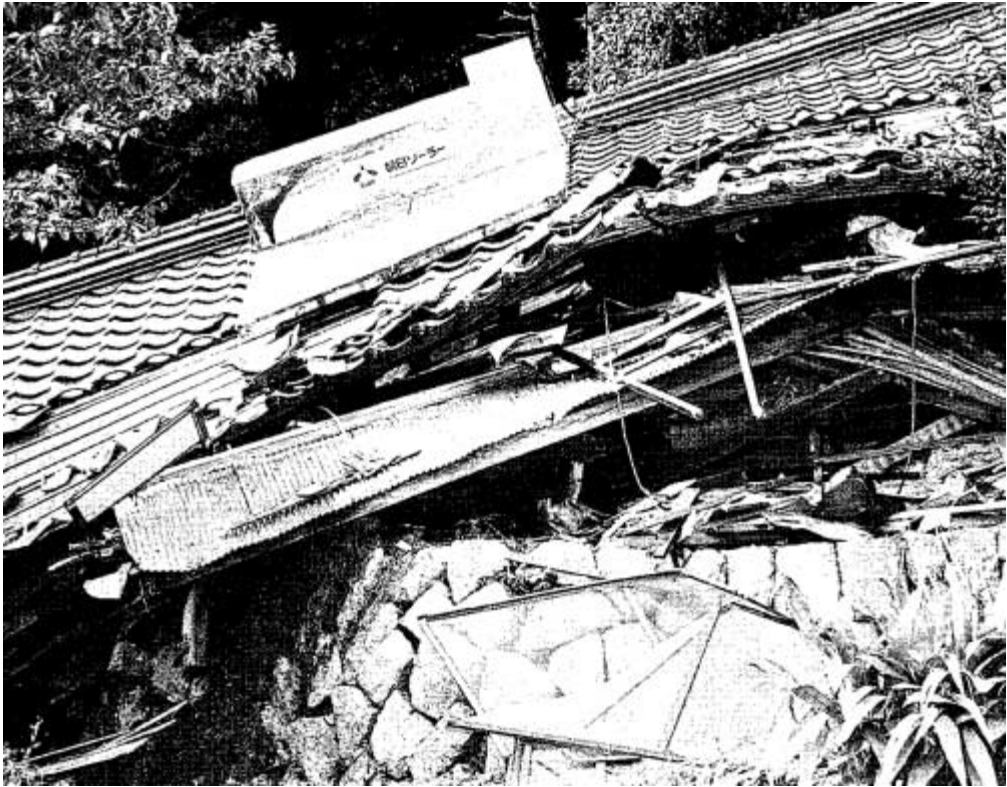
写真1 鳥取県西部地震の被害
